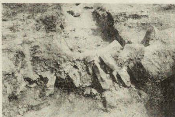
Обр. 6. Разрушен зид от църквата Abb. 6. Zerstörte Mauer von der Kirche
